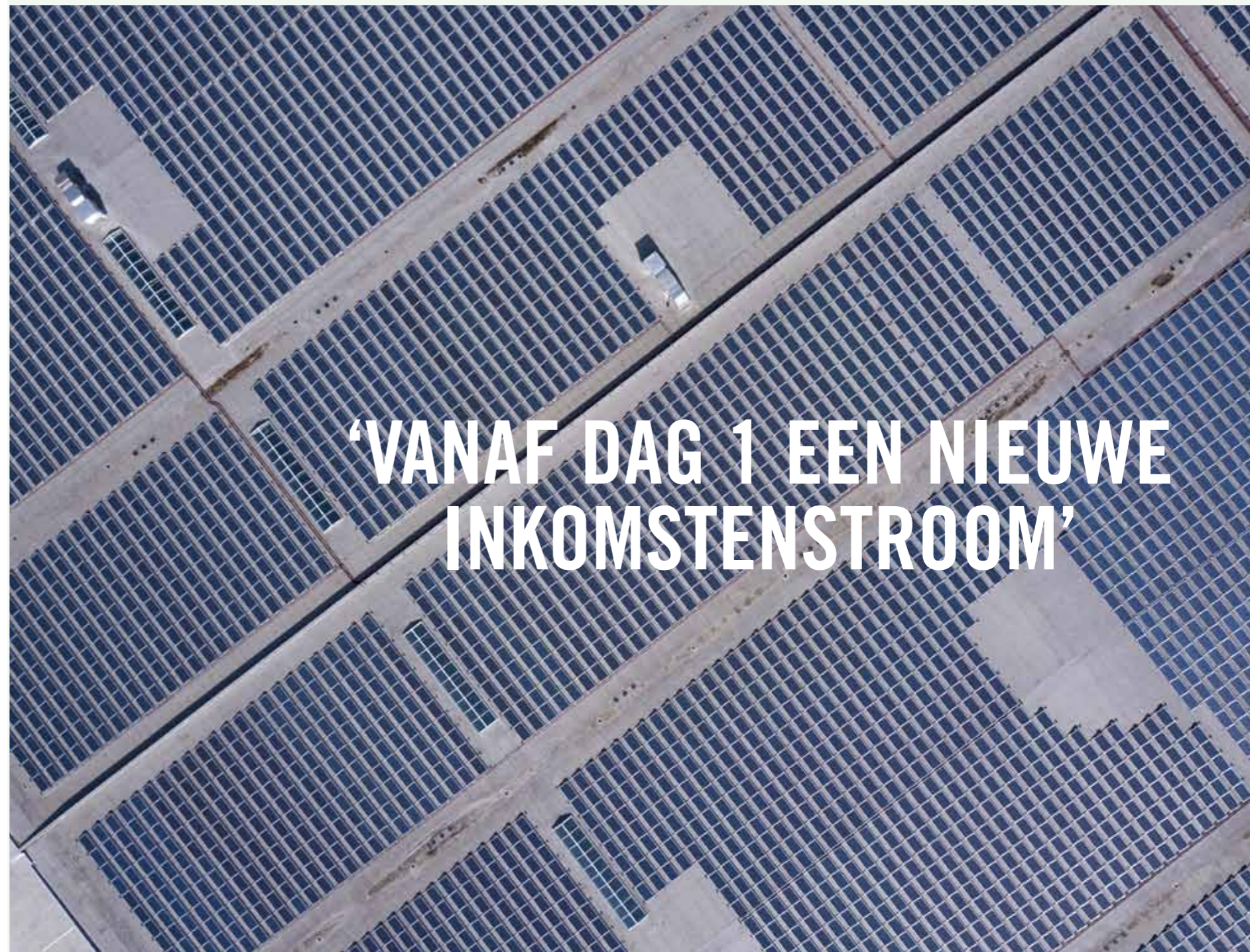
Het grootste zonnedak van Nederland in Venlo. Ruim 28.000 zonnepanelen wekken hier jaarlijks ruim 7.000.000 kWh op.
